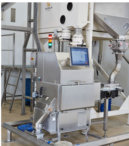
Röntgenscanner bei DANRICE. Das Produkt gelangt über ein Rohrsystem (rechts) auf das Transportband, das es durch den Scanner befördert.
